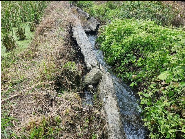
說明：守城份圳福興支線一分線工區現況，渠壁破損嚴重導致長年滲水至荒田處。
