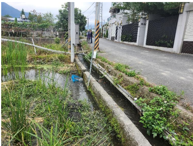
說明：守城份圳福興支線二分線工區現況，周邊鄰近農田，部分圳路段有些微破損。
