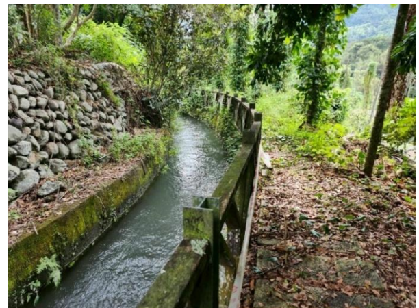
(南投 114CR102) 北圳步道迄點環境照 周邊環境因多年未維護，步道兩側雜草叢生，護欄以生鏽且漆面脫落。
